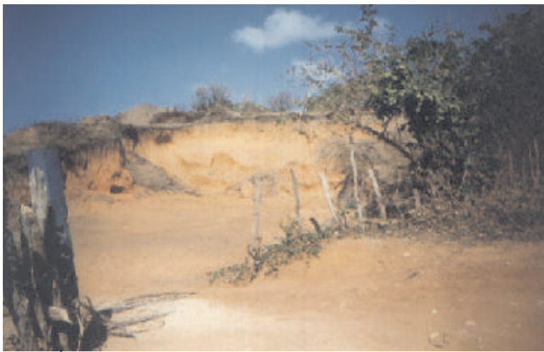
Figura II.27 – Área de empréstimo, exploração de areia na margem esquerda da estrada que dá acesso à Cidade de Paracuru/Ce. F.M. Soares/Janeiro-1999.
