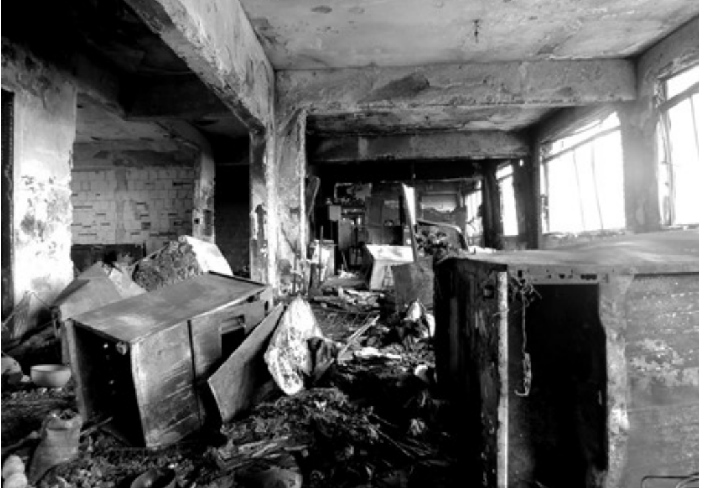
FIGURA 18. 7º Andar do Bloco A após incêndio em 2018 Fonte: Julia Murad, 2019.
