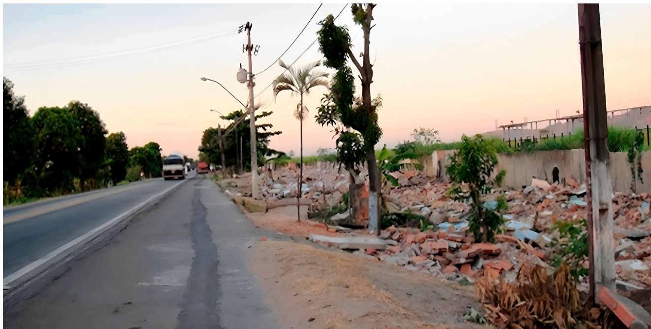
Fig 2. Moradias derrubadas às margens da BR-101 após a população ser reassentada no Morar Feliz
